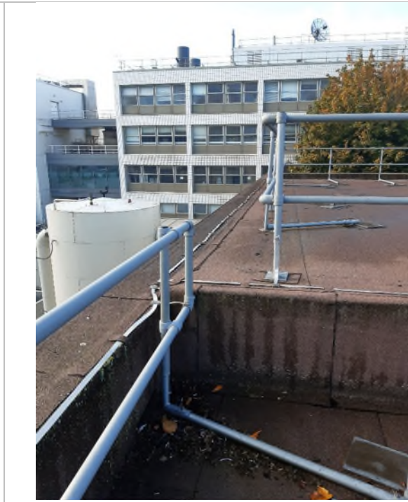
Gap in edge protection
