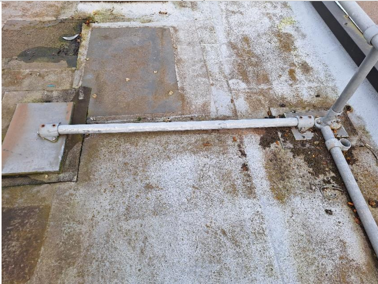
Edge protection anchor, trip hazard
