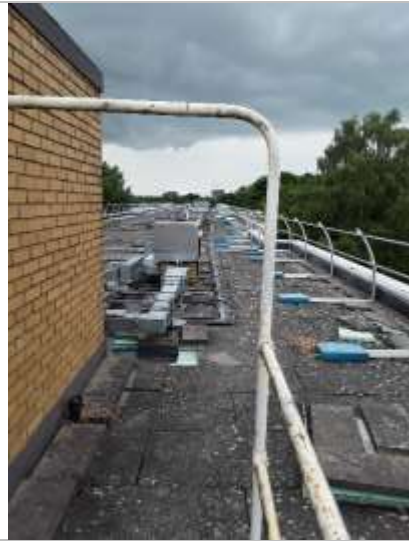
External roof edge protection
